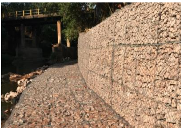
Figura 12. Recente prolongação do muro de arrimo tipo gabião - Campus II da Universidade do Oeste Paulista.
