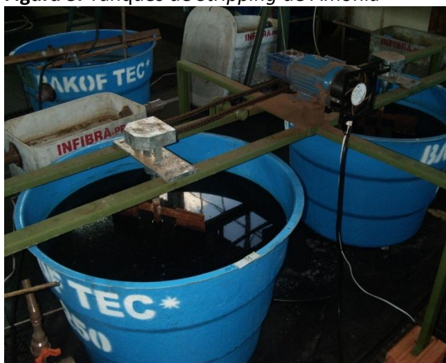
Figura 3. Tanques de Stripping de Amônia
