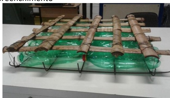
Figura 3. Armação da laje maciça mista, com aço na armadura positiva e bambu na armadura negativa, e garrafas PET como elemento de preenchimento
