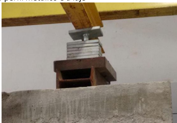
Figura 8. Placas de transferência de cargas entre o perfil metálico e a laje
